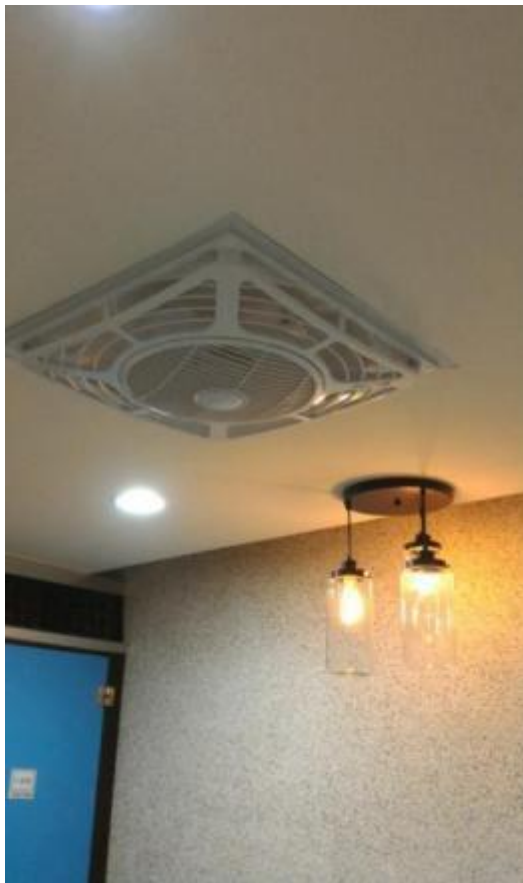
廁所內採機械換氣，減少廁所臭味。
