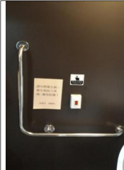
廁間設扶手及緊急求助裝置。
